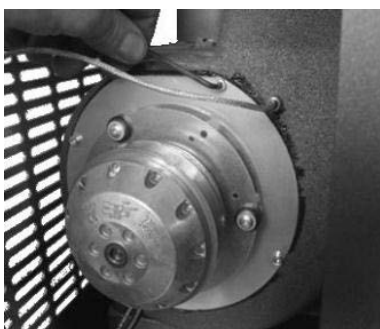
Fig. 54 - Pulizia aspiratore fumi: fase 1
